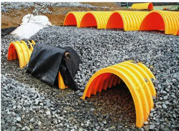
Zwischen den normalen Rigolentunnel eine Sedimentationseinheit Isolator-Row, mit schwarzer Umhüllung durch Geotextil. So lassen sich kostengünstig abfiltrierbare Stoffe (AFS) zurückhalten.
